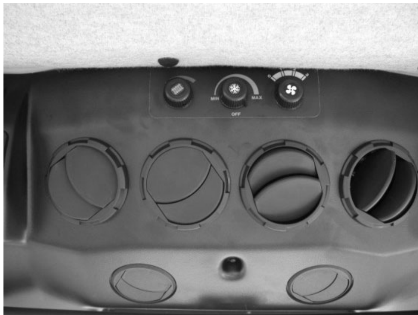
Commandes et diffuseurs d'air de l'installation de conditionnement d'air
